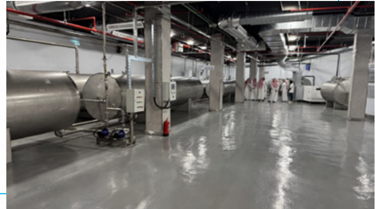
خزانات مياه زمزم في مسجد قباء
